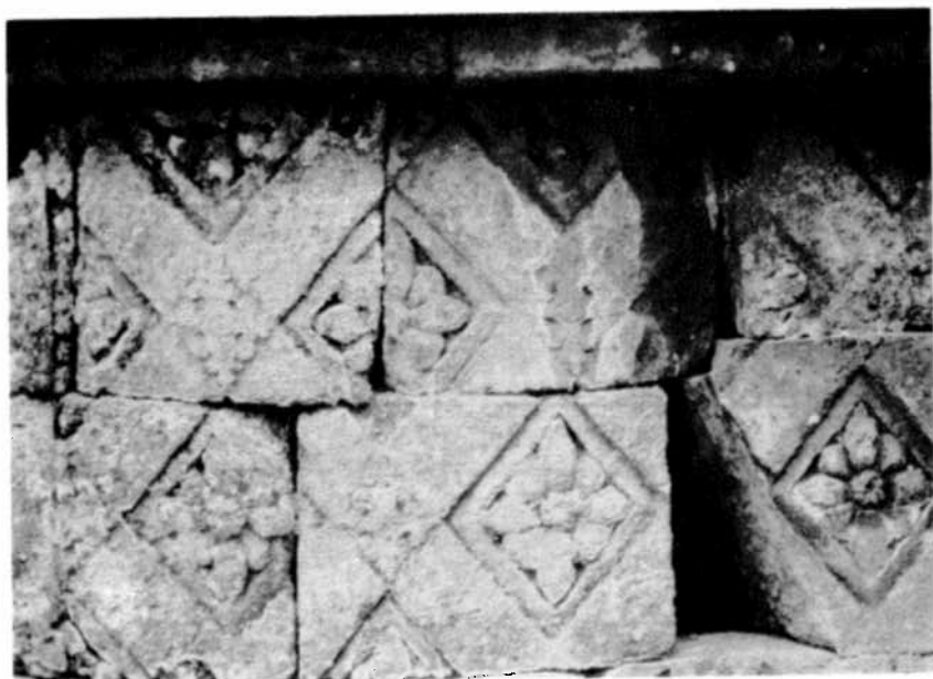
b) Borobudur, agosto 1977. Esempio di fessurazione dei muri. (Saccà)
