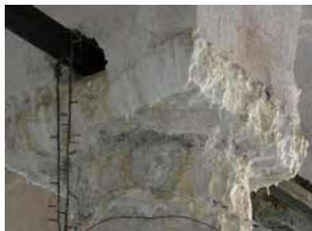
Figura 7. Un intervento condotto con materiale non compatibile ha prodotto un rapido degrado delle superfici
